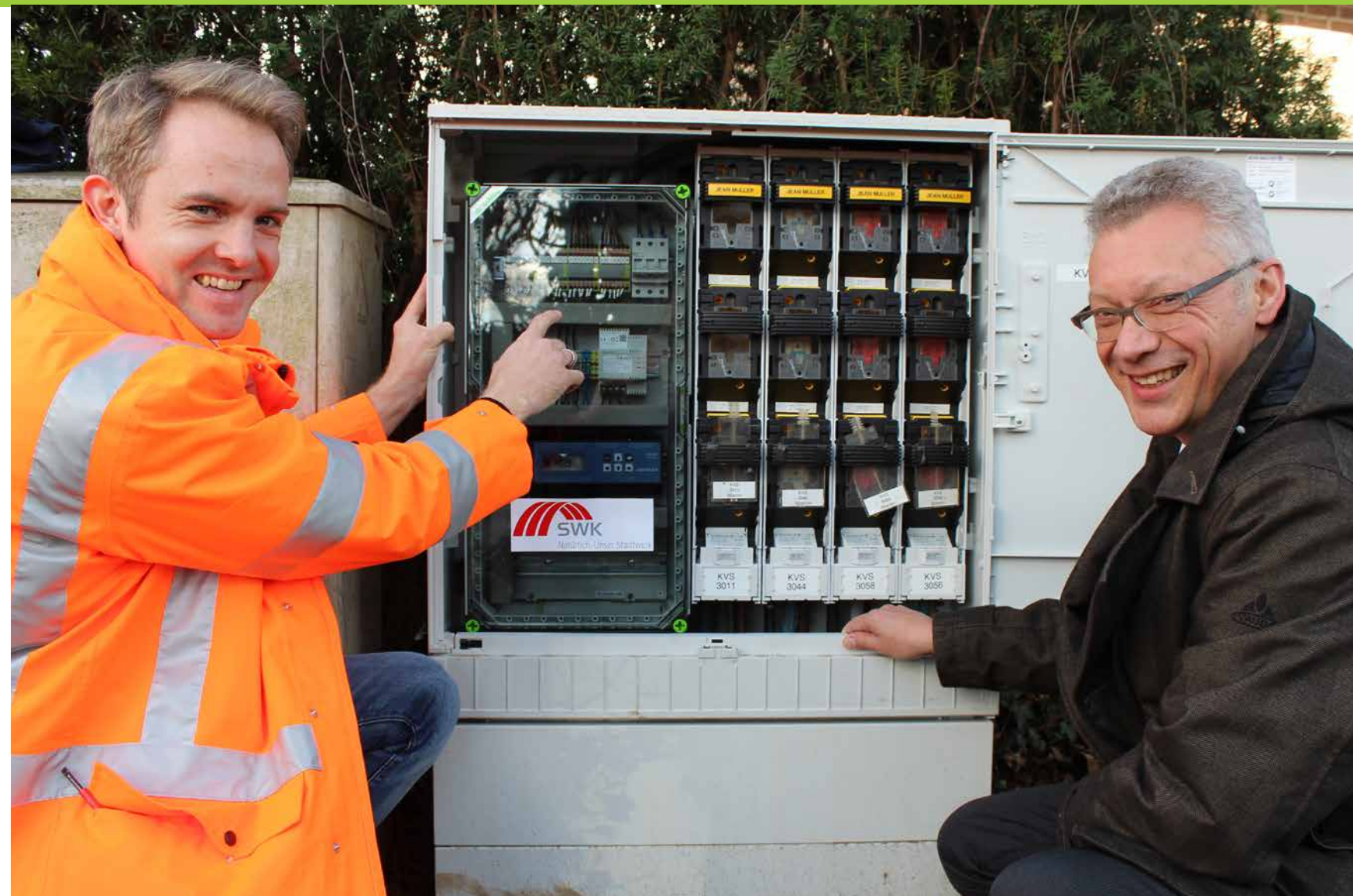
In Kabelverteilerschränken und Ortsnetzstationen werden Netzzustandsdaten erfasst. Konrad Schild, SWK SETEC (links) und Dr. Frank Burau, SWK NETZE (rechts).
